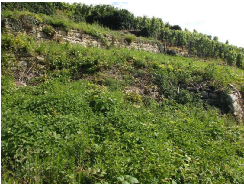
Abbildung 6 Abschnitt der Kategorie TM Sanierungsfall
