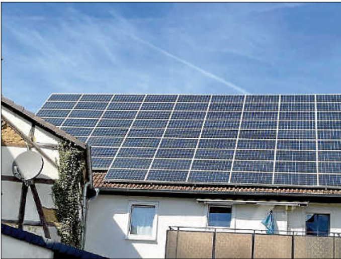
Je voller das Dach, desto wirtschaftlicher ist meist die PV-Anlage
