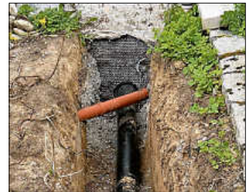
Gebäudeanschluss an ein Wärmenetz
